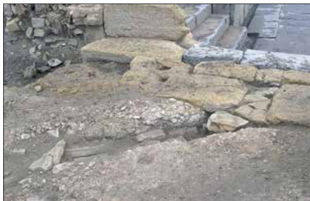
Figura 6. Canalización aguas pluviales desde el Atrio. Fuente: Elaboración propia.
