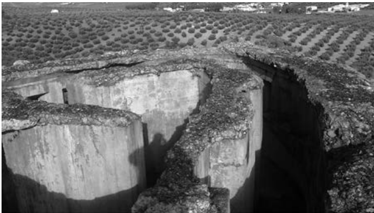
Cubierta destrozada del búnker central de El Picoso-Alamillo .
