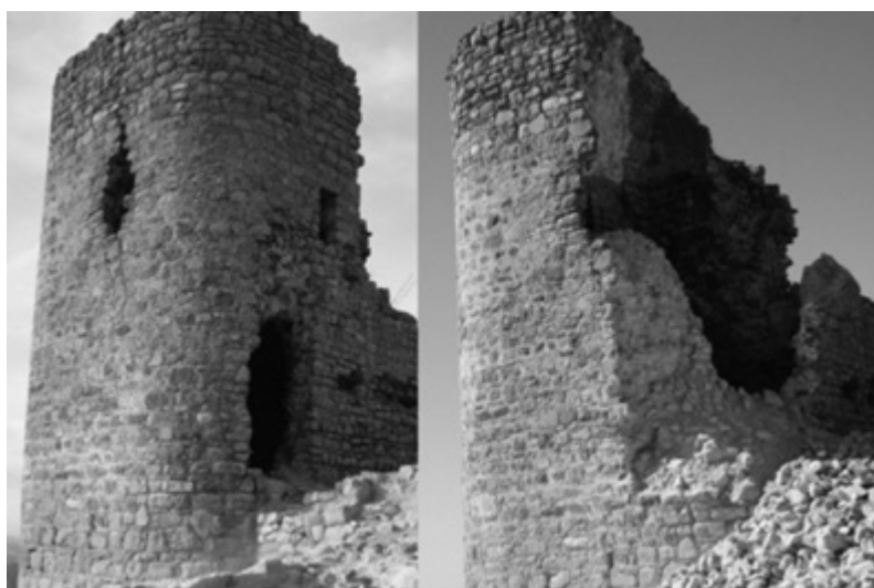
Estado de la Torre del Homenaje a la toma de datos (2009) y su estado posterior al derrumbe (2011). (Fuente: Porcuna D. 2009-11).
